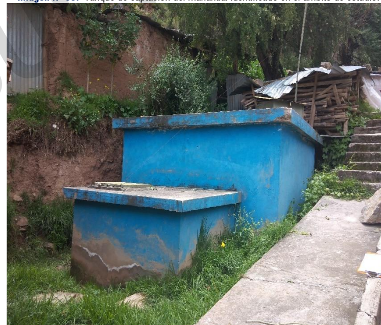
Imagen N° 63: Tanque de captación del manantial identificado en el ámbito de estudio.
