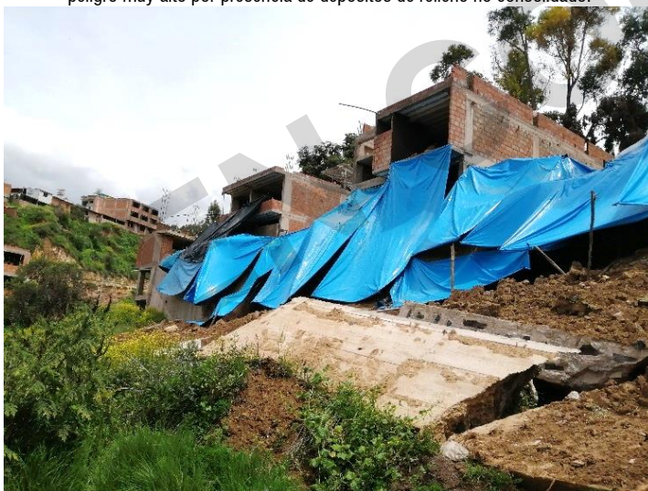
Imagen N° 41: Elemento expuesto de muro de contención colapsado en zona de peligro muy alto por presencia de depósitos de relleno no consolidado.
