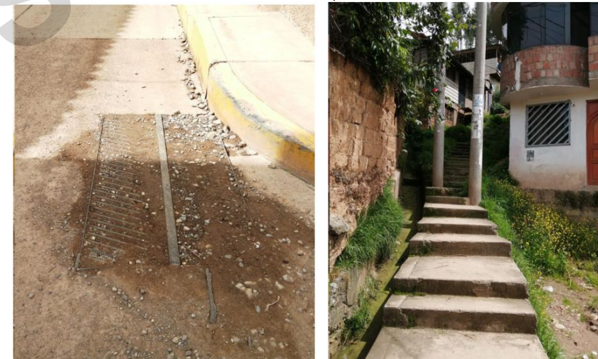
Imagen N° 103: Sumidero obstruido por falta de mantenimiento en calle Rumiñán esquina con calle Rosario Olivera – A la derecha canal pluvial colector descubierto.
